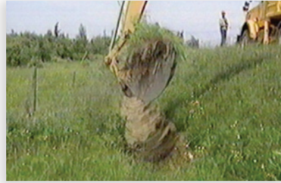
Excavation du fond du fossé à partir du talus opposé à la route, jusqu'à l'entaille.
